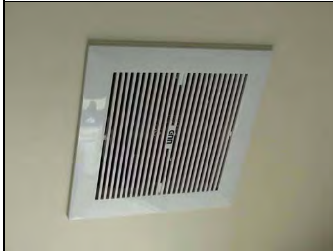
Bathroom Exhaust Fan
